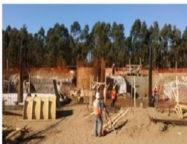
Enfierradura vertical en Sedimentador N° 1.
